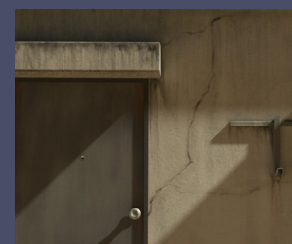
ひび割れた壁
