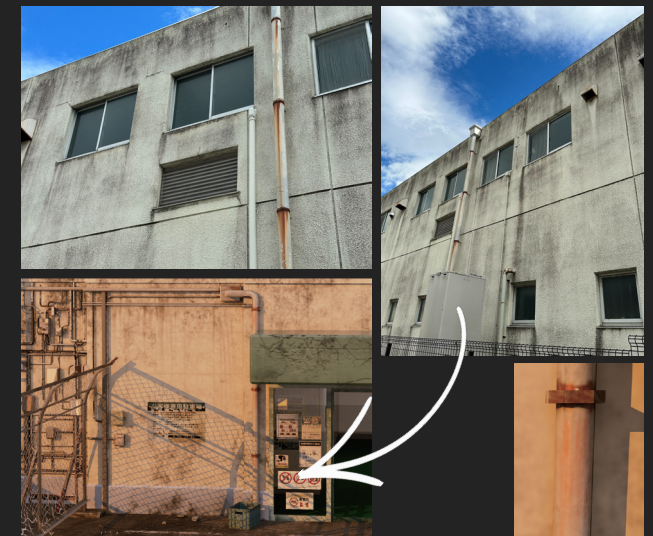
パイプ管の漏れ
