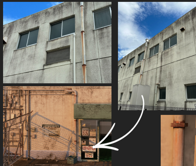
パイプ管の漏れ
